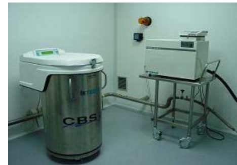
Zona Criocongelación: tanque almacenamiento nitrógeno
